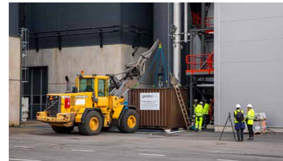
Granitor Systems har byggt anläggningen som transporterats till Växjö och kopplats ihop med kraftvärmeanläggningen på Sandviksverket. Pilotstudien löper under cirka tre år.
